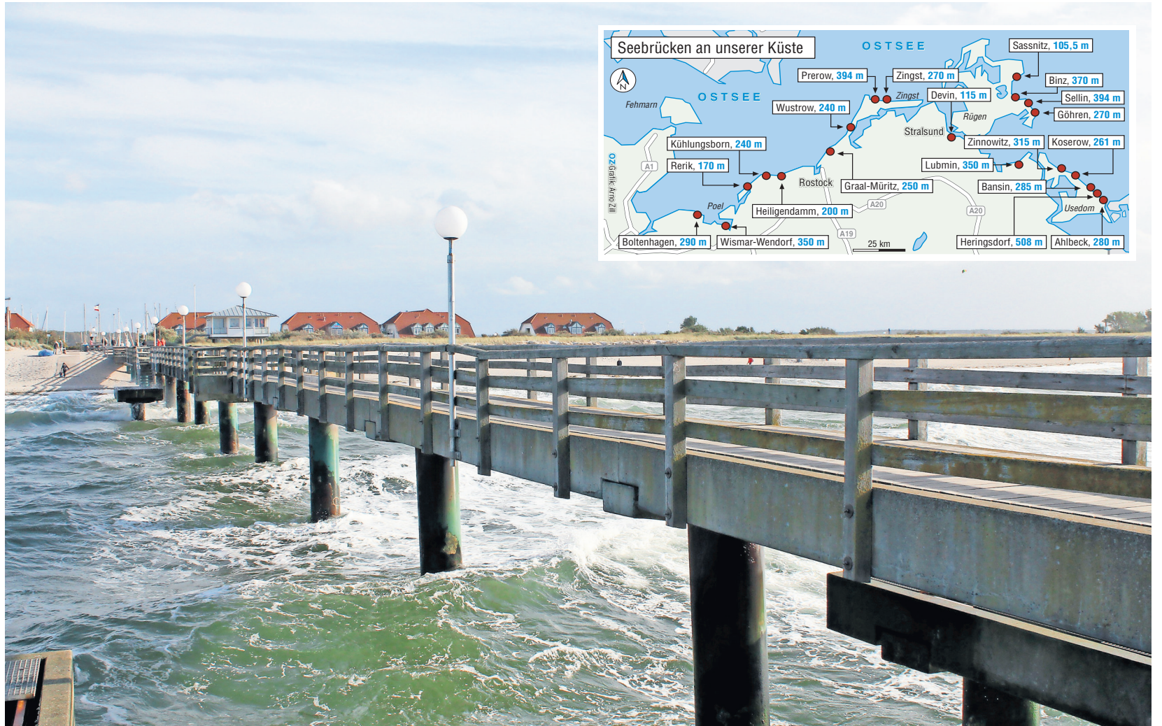
Die Seebrücke in Rerik ist sanierungsbedürftig.
