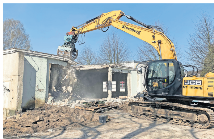
Die Firma AE Schubert hat mit den Abrissarbeiten an der alten Mensa der Buchenbergsschule begonnen.
